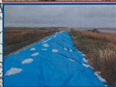
堤防亀裂 L≒100m H≒1~2m すべり L≒150m H≒1~2m
