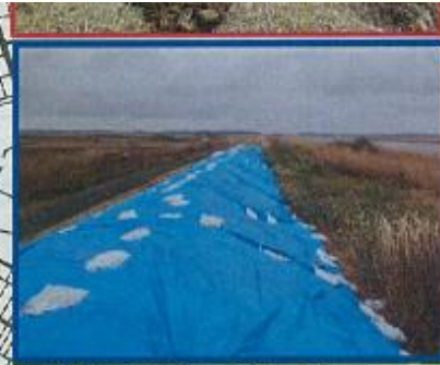
堤防亀裂 L≒100m H≒1~2m すべり L≒150m H≒1~2m
