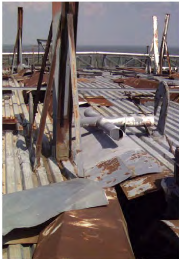
図 7.2.: 石棺シェルターの隙間が大気中水分の浸水を許している。[オリジナル]【全部で 1000 m 2 ほどある隙間から雨水（英文では atmospheric water）が 2000 m 3 /年ほど石棺内（特に 4号原子炉）に侵入する。この湿気の為に腐食と放射能漏れが進んだ。】
